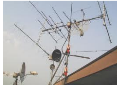
sistema di antenne
